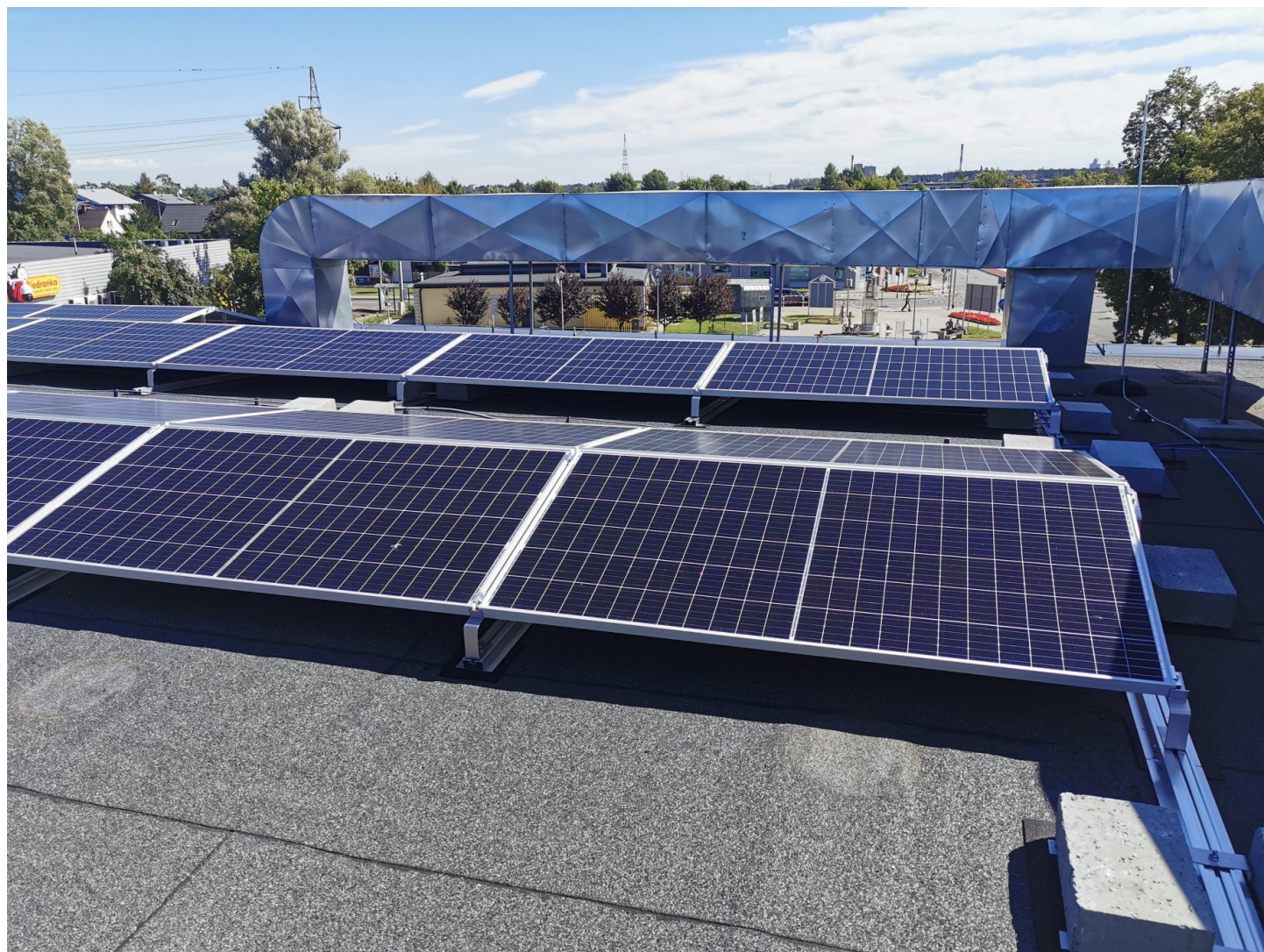
Fotowoltaika na dachu budynku Kopalni Kultury
