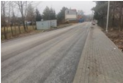
• Ulica Siemianowicka gotowa
