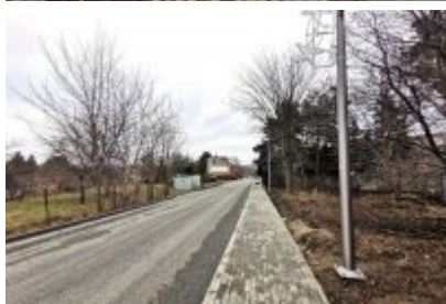
• Ulica Siemianowicka gotowa
