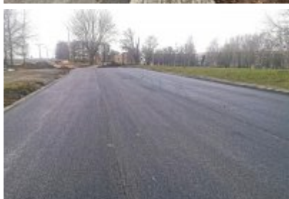
• Ulica Siemianowicka gotowa
