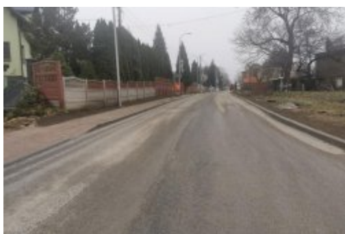
Ulica Siemianowicka gotowa
