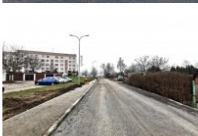
• Ulica Siemianowicka gotowa
