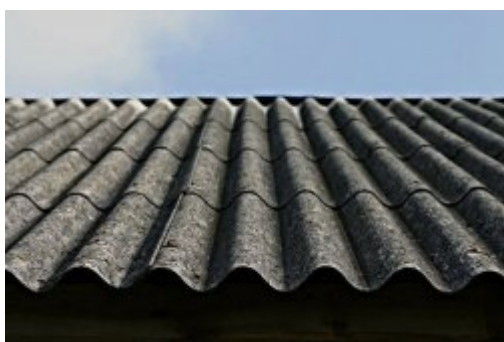
Pokrycie dachowe z azbestu
