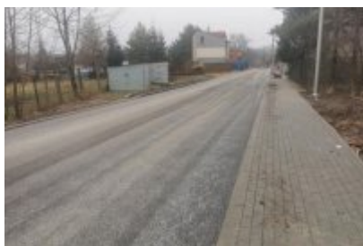
• Ulica Siemianowicka gotowa
