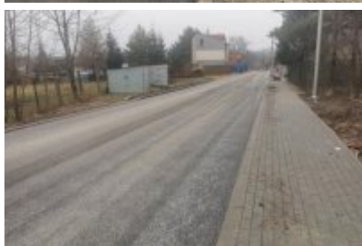
Ulica Siemianowicka gotowa
