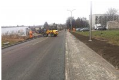
Ulica Siemianowicka gotowa
