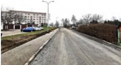
• Ulica Siemianowicka gotowa
