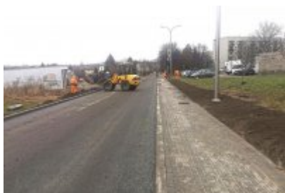
• Ulica Siemianowicka gotowa
